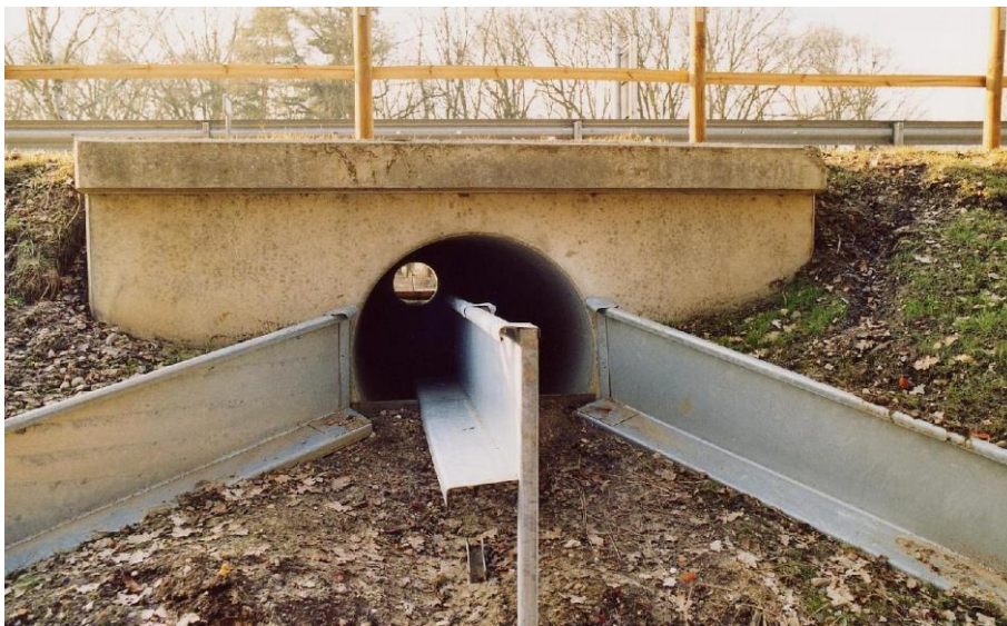
Fot. 4. Tunel dla płazów pod ulicą (źródło: pl.wikipedia.org)
